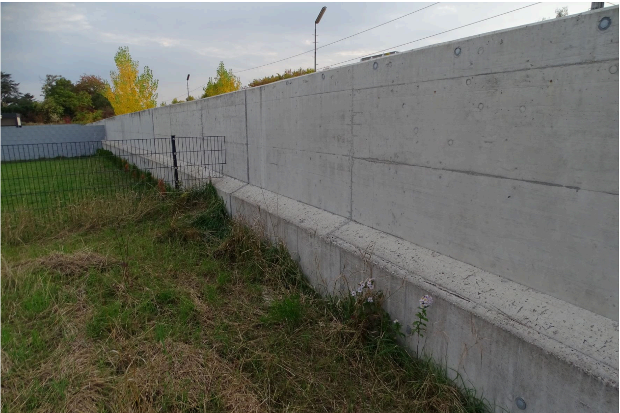
Abb. 21: Neue Grenzmauer zu neuer Siedlung am nördlichen Ostrand. Änderungen werden sich hier im Projektumsetzungsfall wohl nicht ergeben.
